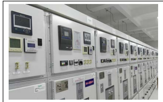
Die Energie des Rechenzentrums wird über mehr als 50 Schaltanlagenkreise im Medium- und Niederspannungsbereich unterverteilt.
